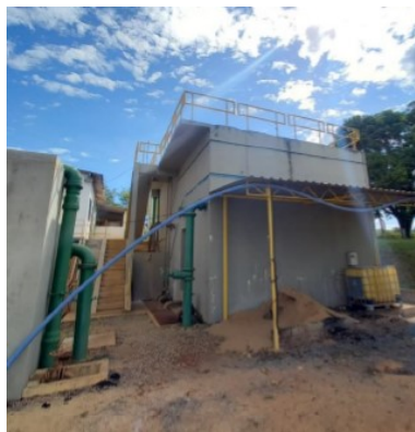
Estação de Tratamento de Água da sede de Martinho Campos/MG
